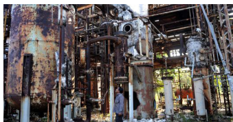
L'usine Bhopal, après son explosion ... l'impossible décontamination.
